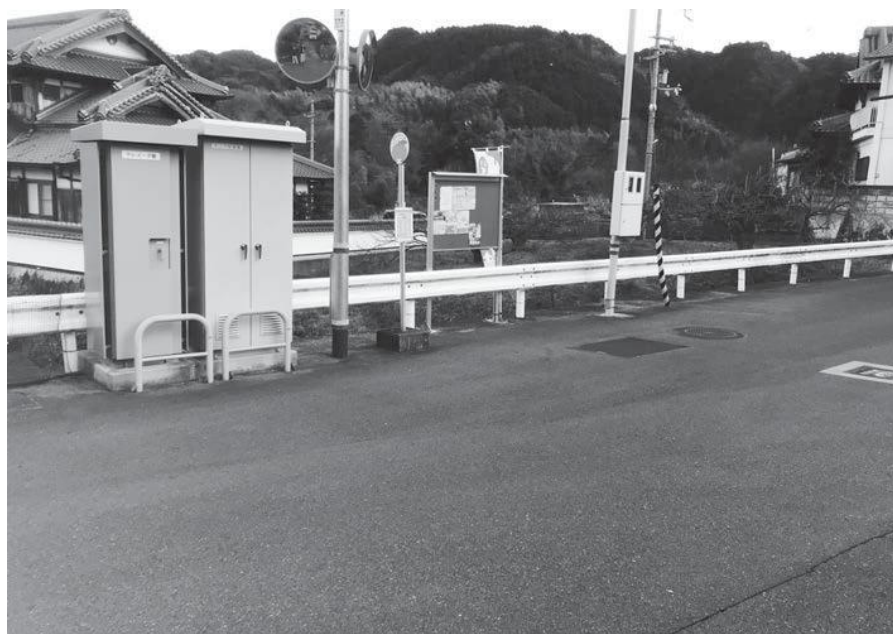
九鬼加圧ポンプ所
