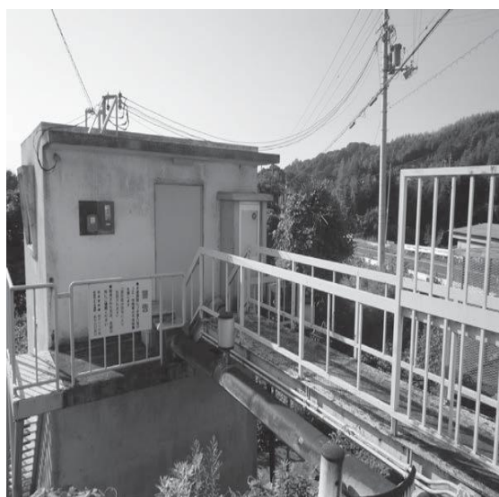
善正加圧ポンプ所
